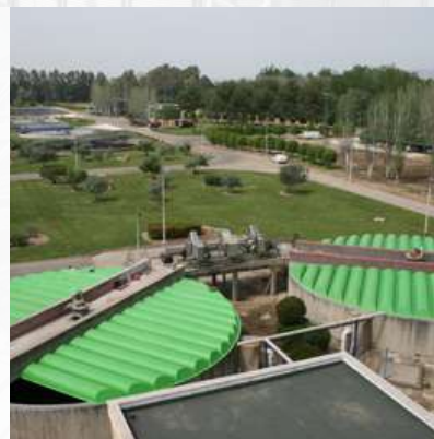
Elementos de cobertura em PRFV para equipamentos de ETAR
